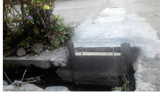
Gambar 18 Pintu air pada saluran penghubung
