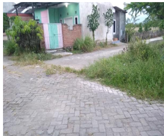
Gambar 8 Kondisi eksisting saluran pada sisi sungai
