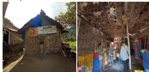
Gambar 8. Gudang pasca panen sebelum perbaikan
