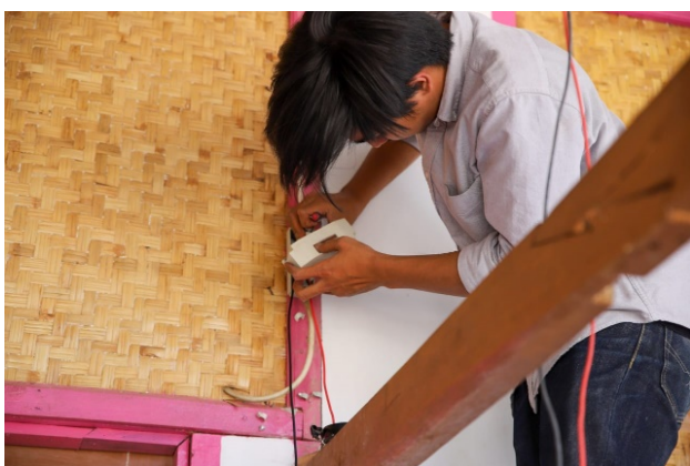
Gambar 3. Pengkabelan antar panel surya dan solar charger controller
