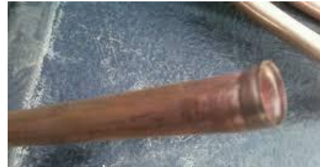
Gambar 2. Kerusakan ujung pipa flare
