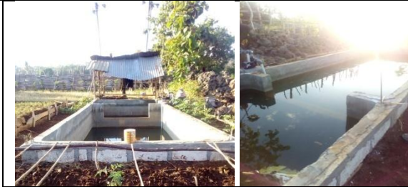
Gambar 3. Bak penampungan air
