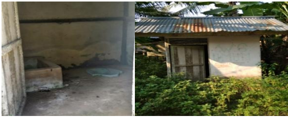
Gambar 4. Jamban Desa Sebelum Renovasi
