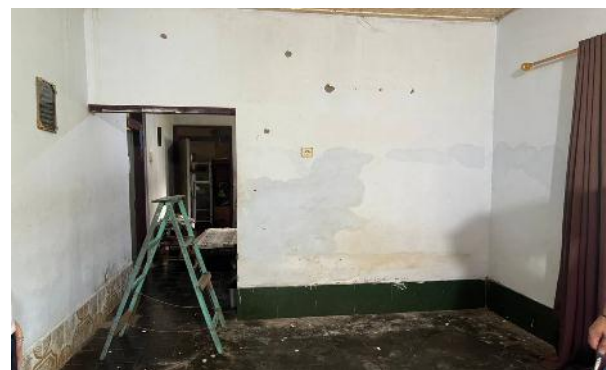
Gambar 10. Kondisi Rumah Mitra UMKM Sebelum Diperbaiki
