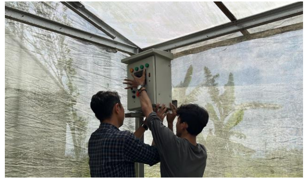
Gambar 7. Instalasi Elektronik IoT
