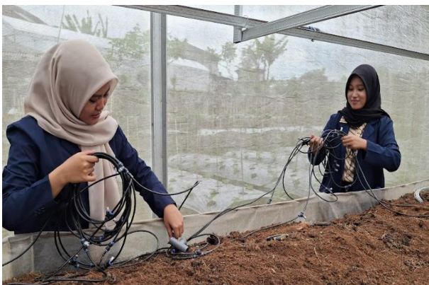
Gambar 6. Instalasi Mekanik Irigasi
